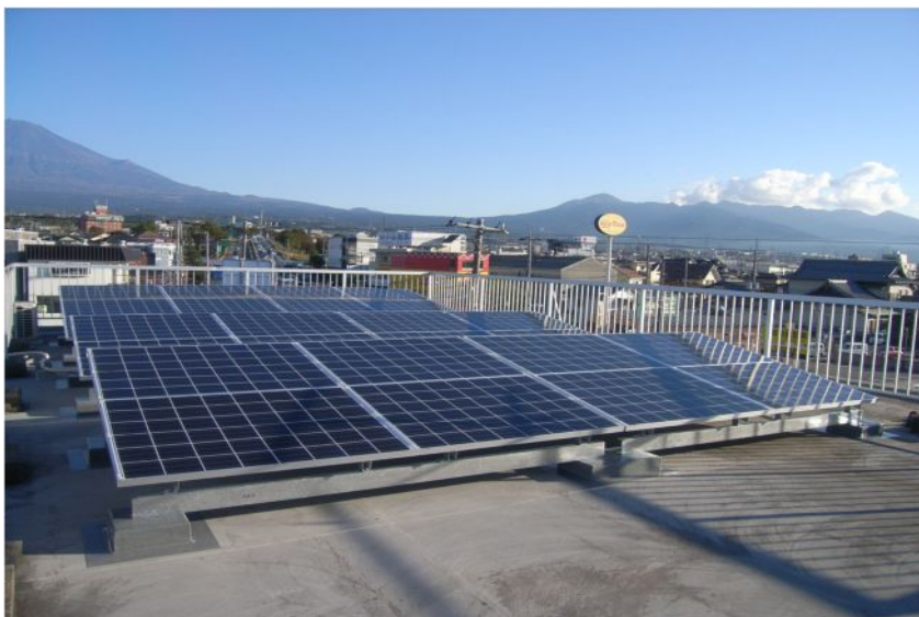
和田建設(株)太陽光発電所 (当社事務所屋上)
